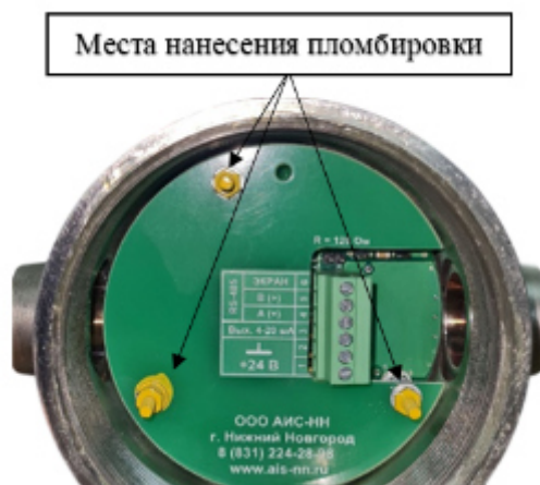
Рисунок 2 – Общий вид опломбированного датчика посредством желтой краски и места нанесения пломбировки
